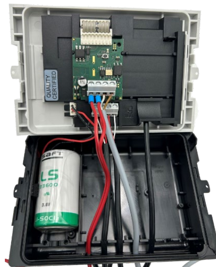
Figure 7 Exemple de module correctement câblé
